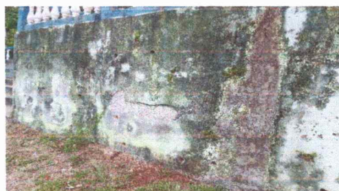
Foto 6: REPELLO EN MAL ESTADO
