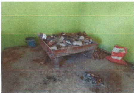
Foto1: PISO EN MAL ESTADO
