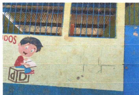
Foto 4: ESCASO DE PINTURA EN PAREDES
